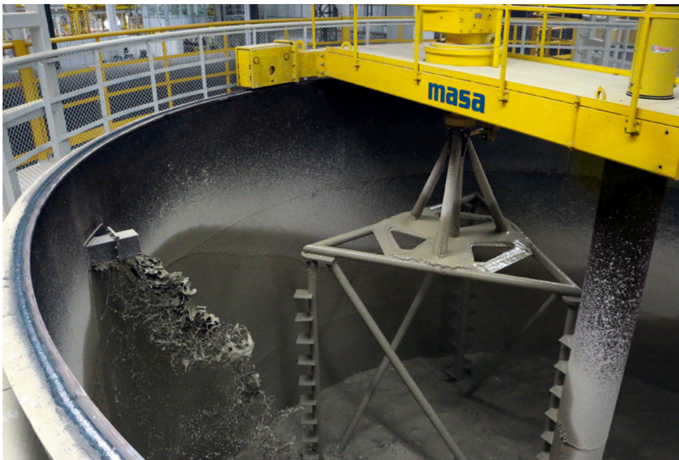
Промежуточное складирование песчаного шлама с автоматическим контролем плотности
